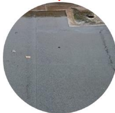
Renflement / Obstacle faisant obstacle à l'écoulement
