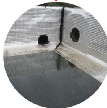
Évacuations mal positionnées
