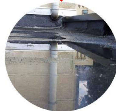
Mauvaises pentes Défauts de planéité
