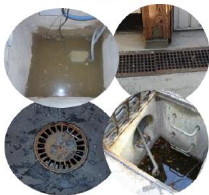
Réseau pluvial extérieur / Puisards / Regards
