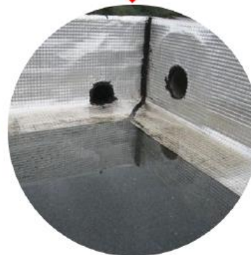
Évacuations mal positionnées
