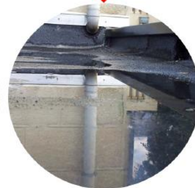
Mauvaises pentes Défauts de planéité
